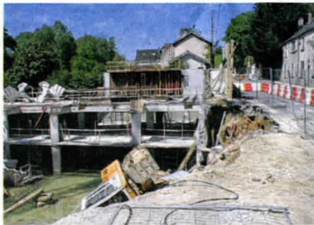
L'engin de chantier a chuté mercredi 25 avril.
